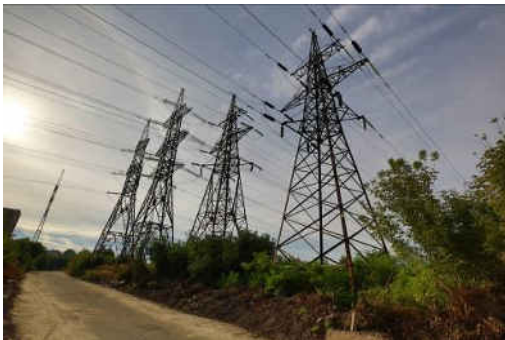
Рис.3. Группа воздушных линий электропередачи вблизи жилых домов. 3
